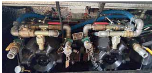
Рис. 5 Внешний вид насосов со счётчиками объёмными, установленными на деаэсере, для раздельного учёта расхода ПОЖ типов I и IV
